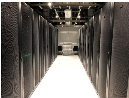
専用データセンタ（S棟）
